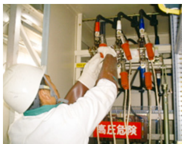
電気の安全管理、省エネルギー管理
