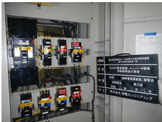
写真 2.1.5-1 出力盤 更新前
