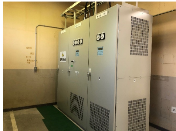
写真 2.1.19-2 直流電源設備 更新後
