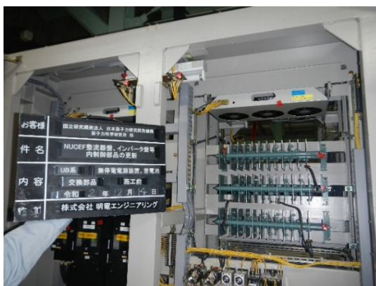
写真 2.1.5-3 整流器盤 更新前
