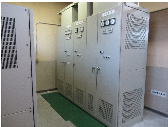
写真 2.1.19-1 直流電源設備 更新前
