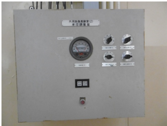
差圧調整盤 更新前
