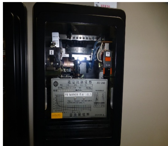
写真 2.8.2-2 電気室饋電盤 T 相用 過電流継電器 (OCR)
