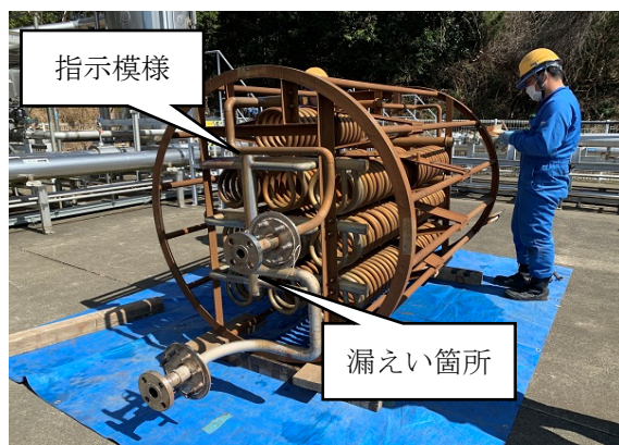
写真 2.8.4-1 No.2 蒸発器の気化管
