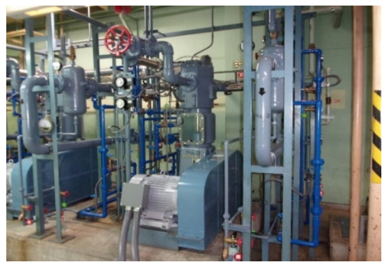
写真 2.1.6-1 空気圧縮機 更新後
