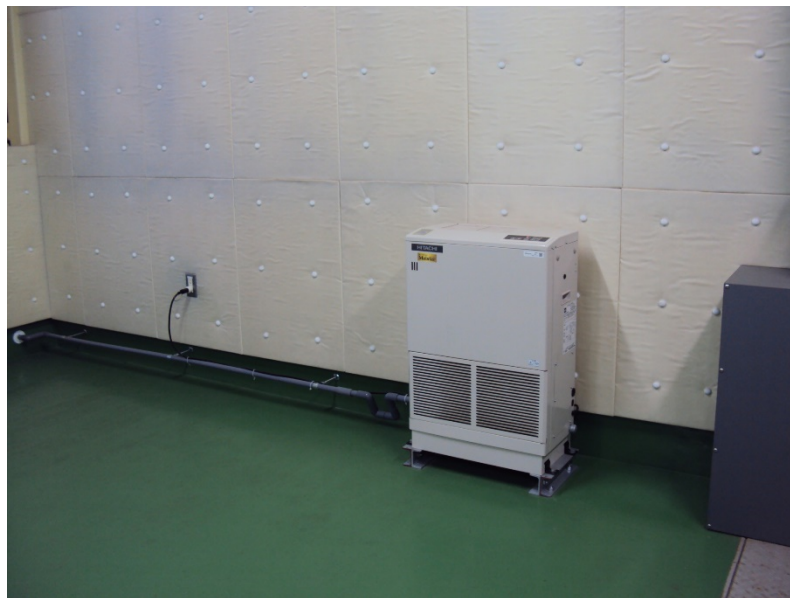
写真 2.1.16-1 EG 室除湿器の設置
