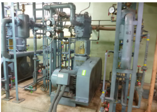
写真 2.1.6-1 空気圧縮機 更新前
