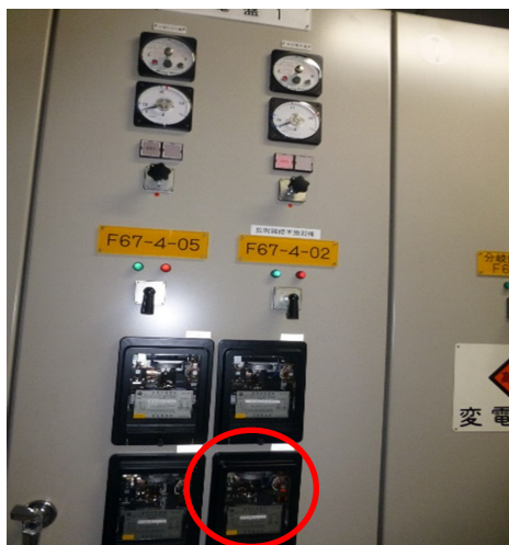
写真 2.8.2-1 電気室饋電盤 1 外観
