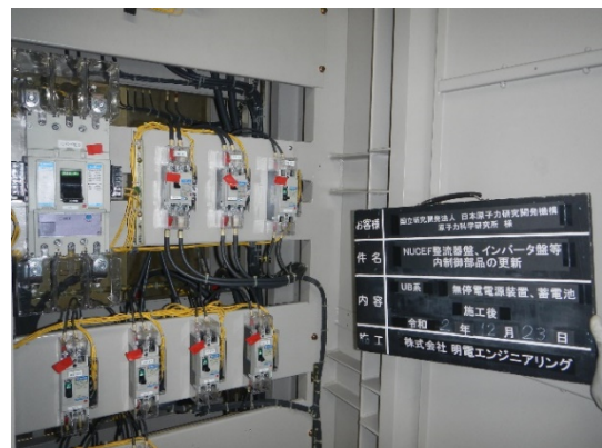
写真 2.1.5-2 出力盤 更新後
