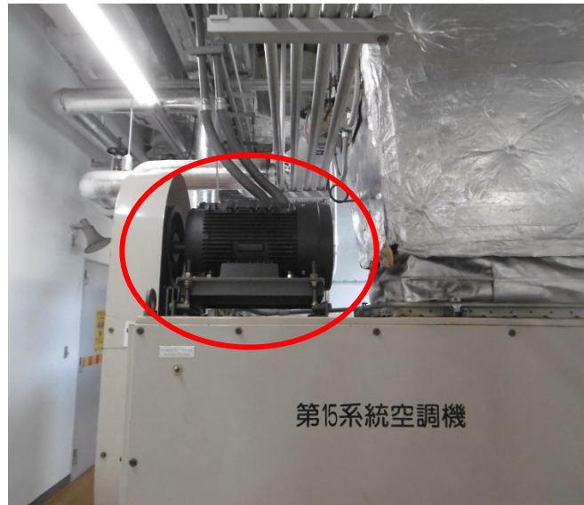
写真 2.1.12-2 第4研究棟東棟空調機用電動機 更新後
