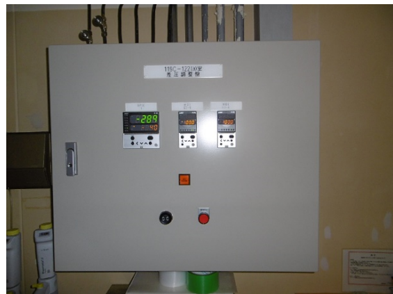
差圧調整盤 更新後
