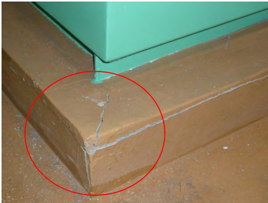
破損確認時 (平成23年3月23日撮影)
