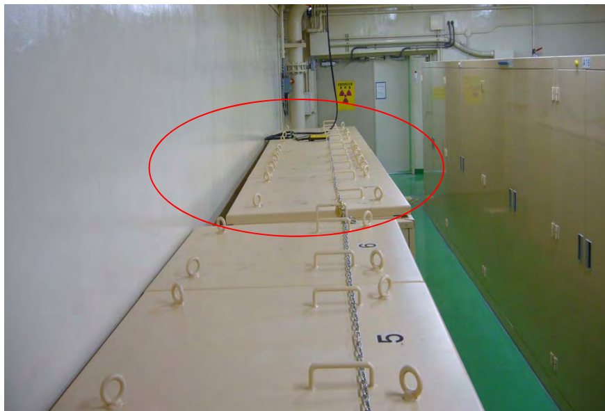
破損確認時(位置ズレ:平成23年3月15日撮影)
