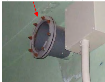
排気第11系統ダクト接続部(H23.3.11)
