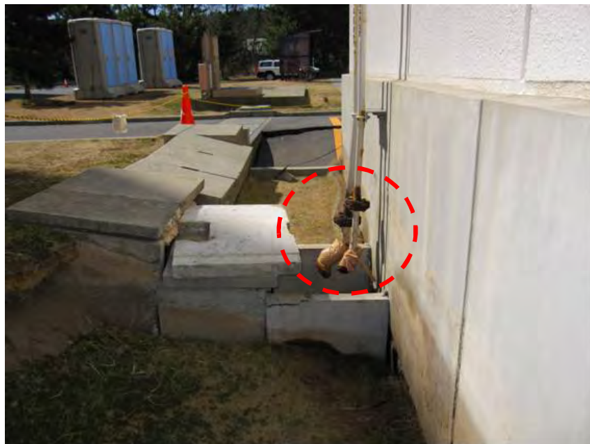
重油配管2本の破断(復旧前)
