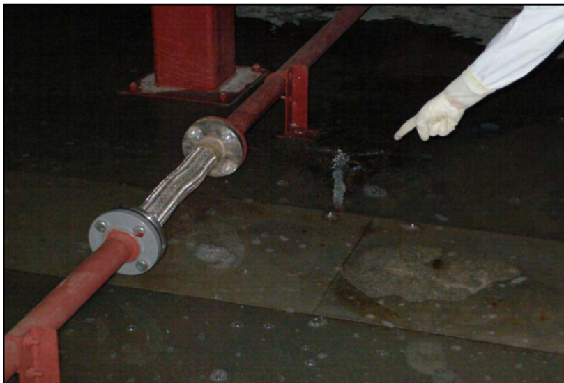
亀裂箇所(処置前)
