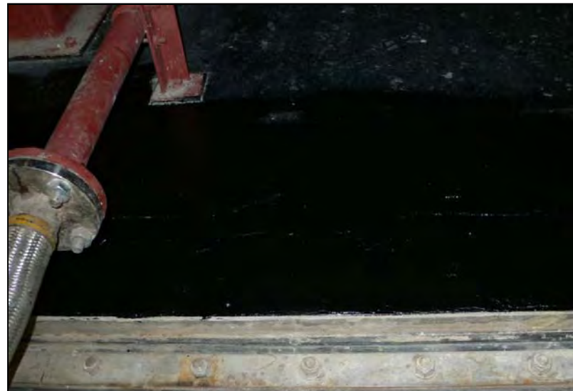
亀裂箇所(処置後) H23.11.15撮影
