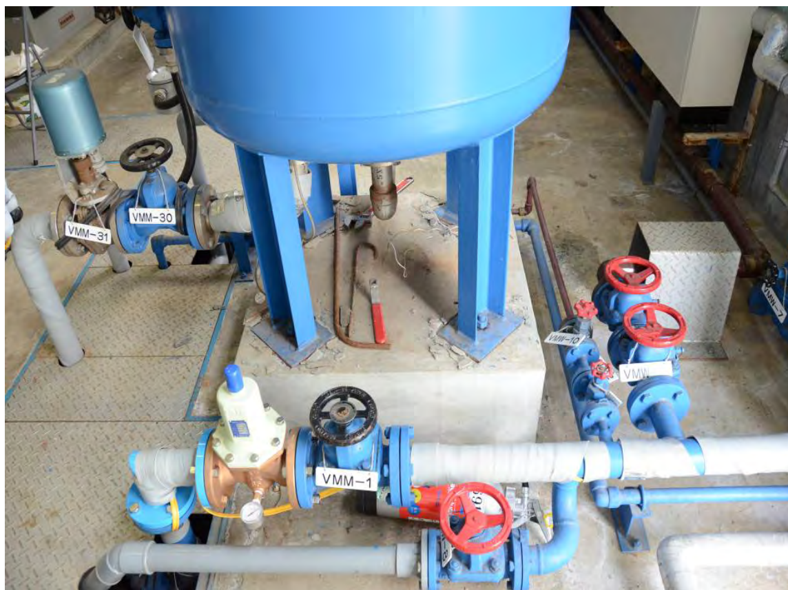
純水製造装置土台のひび
