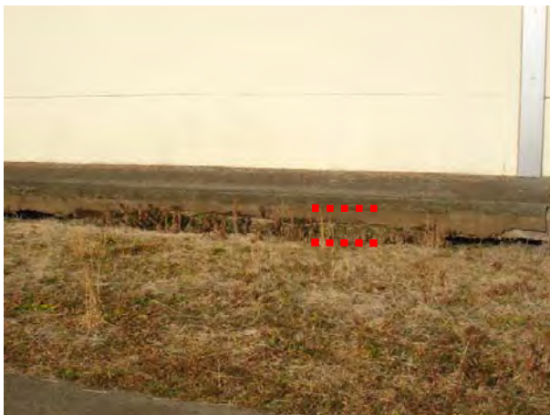
原子炉建家周辺の地盤沈下
