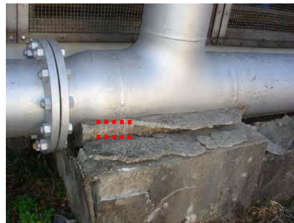
2次冷却塔周辺の地盤沈下
