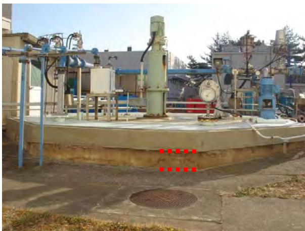
廃液中和槽周辺の地盤沈下
