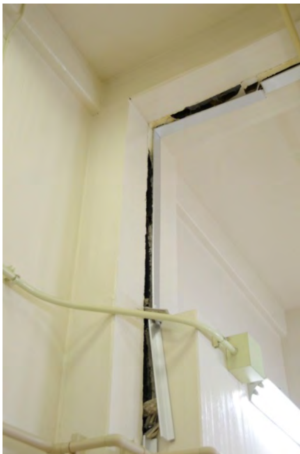
内側からみた亀裂
