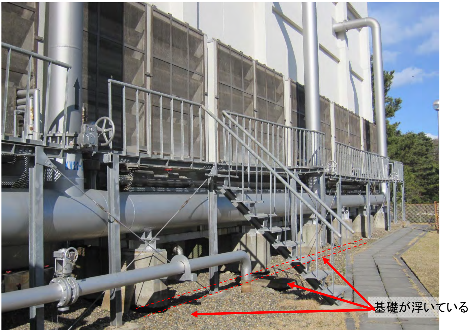
炉-04~1 JRR-3 地盤沈下による2次冷却材配管支持の基礎コンクリートの露出等
