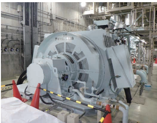
解体前のディーゼル発電機(写真5)
