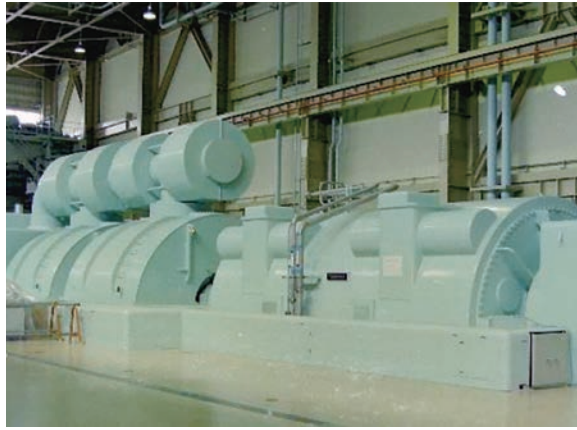
タービン発電機
