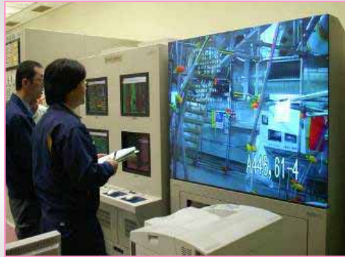
〔総合漏えい監視システム〕
