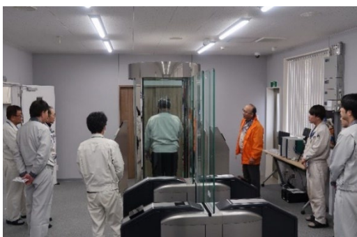
出入管理設備
