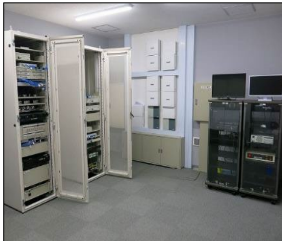
1F: サーバー室
