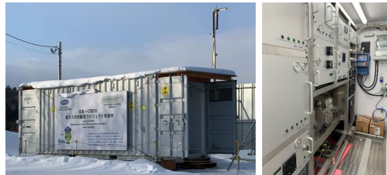
幌延に設置されたTXLの外観と内部
