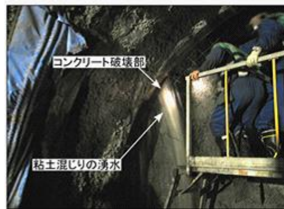
大量湧水発生状況（深度350m）
