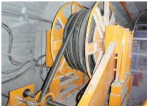
電気ケーブル巻上機(西立坑深度140m接続部)
