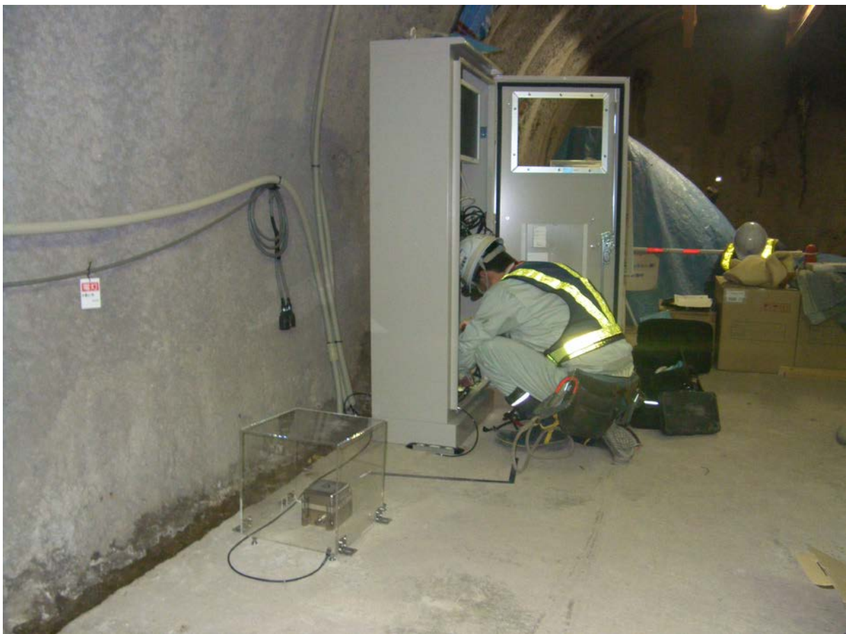
地震観測モニターの設置の様子
