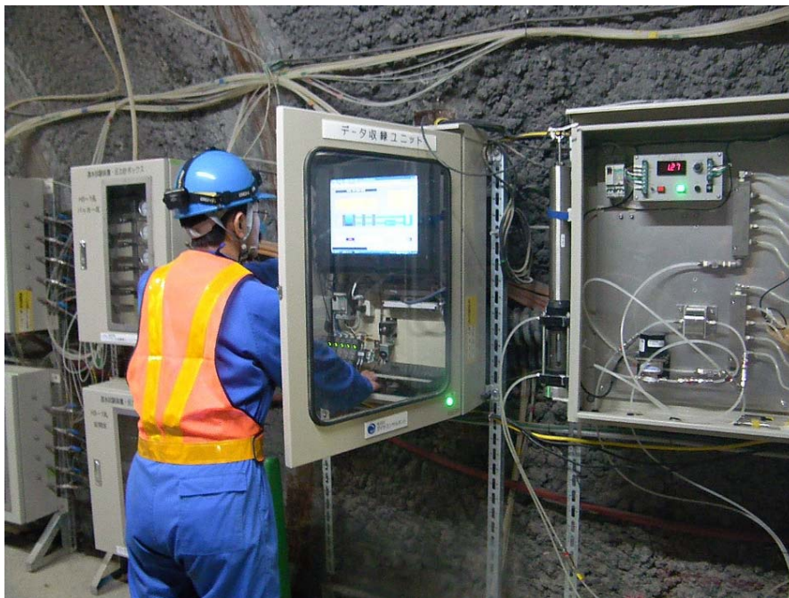
地下水の水圧・水質モニタリングの様子 (350m調査坑道)
