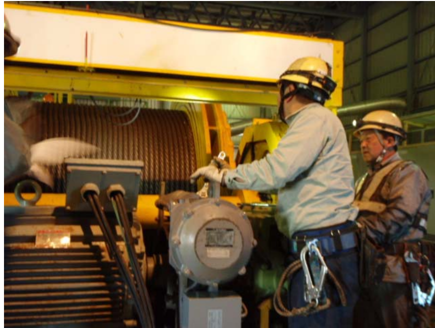
機械設備の維持管理の様子
