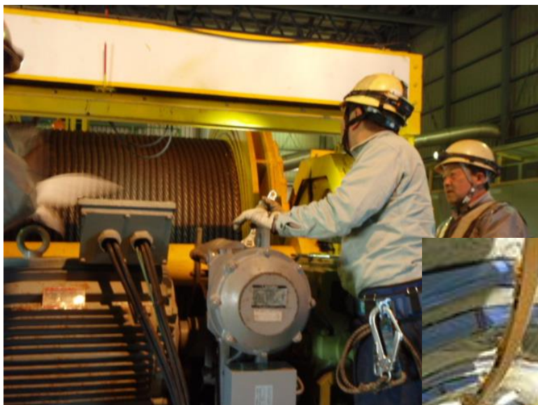
機械設備の点検・整備
