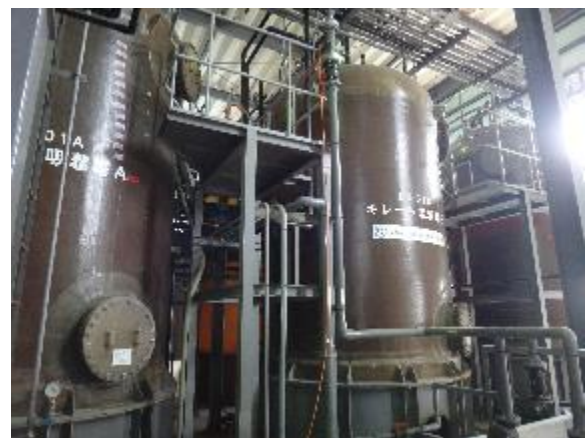
（脱ホウ素設備）
