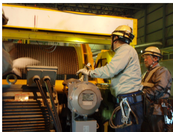
写真 6 地下施設の維持管理状況（機械設備の点検・整備）
