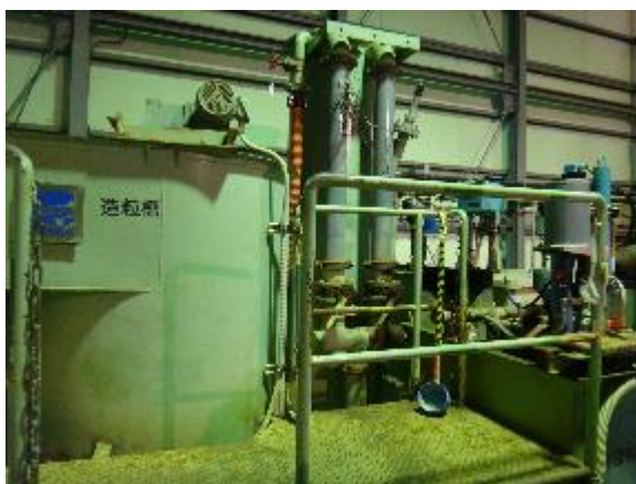
（濁水処理設備）
