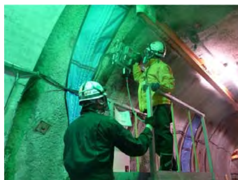
維持管理状況 : 検知器の点検
