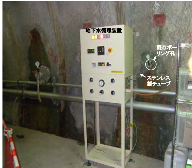
写真 1 採水ラインを全てステンレス製にした地下水循環装置
