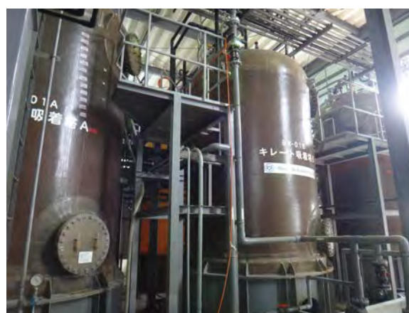
（脱ホウ素設備）
