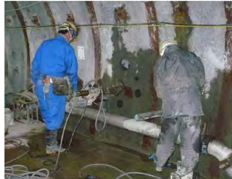
コンクリート材料の坑道周辺への影響を把握するための調査 (コンクリート壁面からのサンプル採取)
