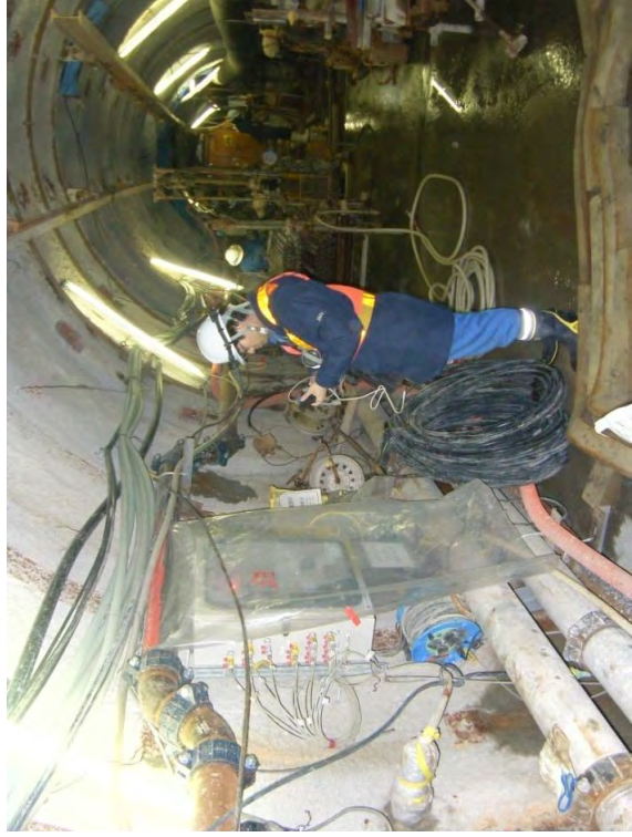
地下水の水圧・水質モニタリングの様子 (250m調査坑道)
