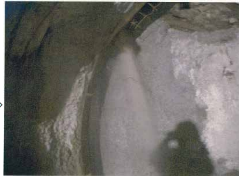
周回坑道(東)湧水発生箇所の写真
