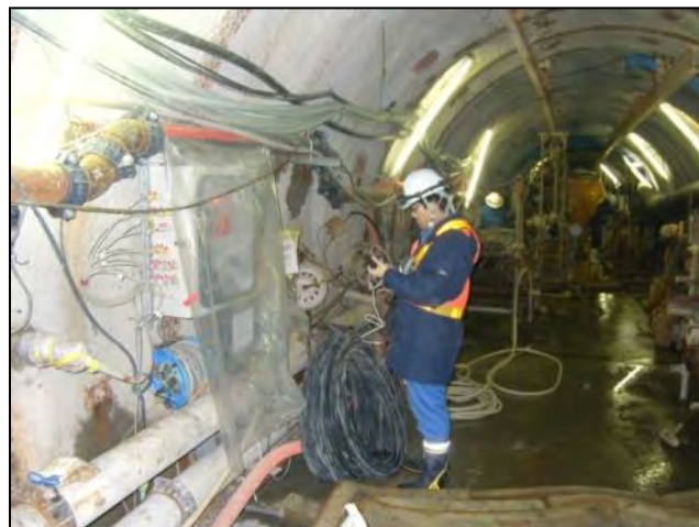
地下水の水圧・水質モニタリングの様子 (250m調査坑道)
