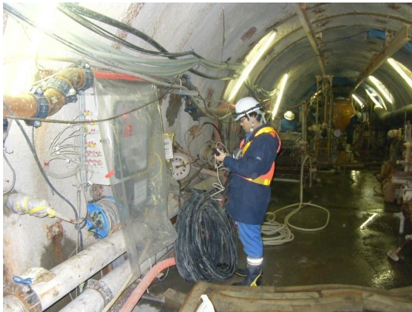
地下水の水圧・水質モニタリングの様子 (250m調査坑道)
