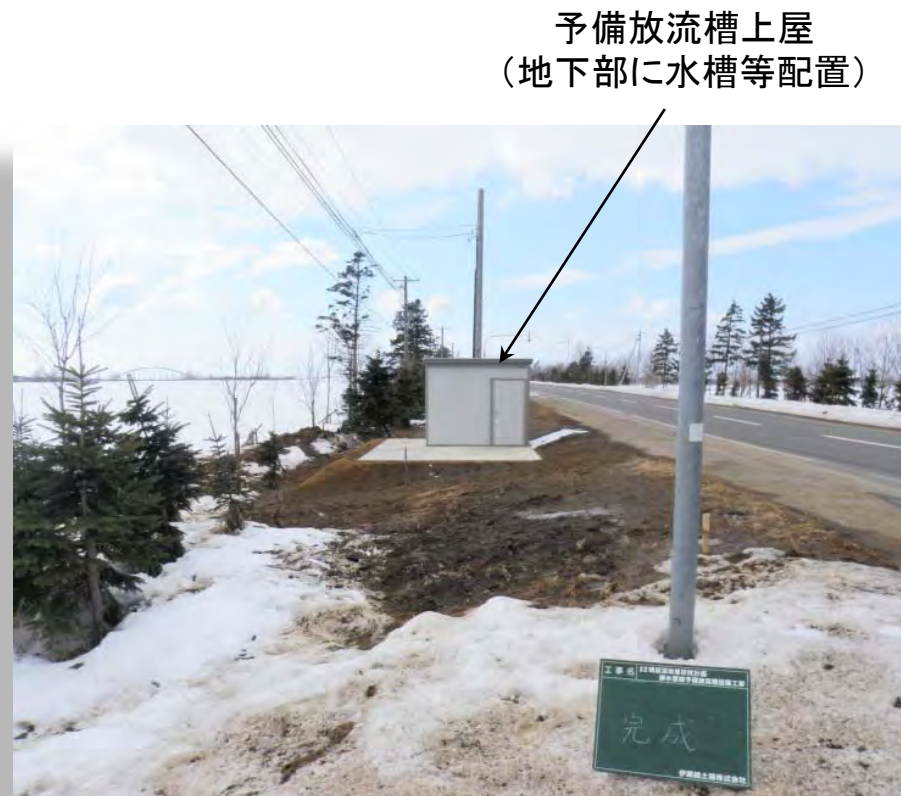
予備放流槽(23年3月)
