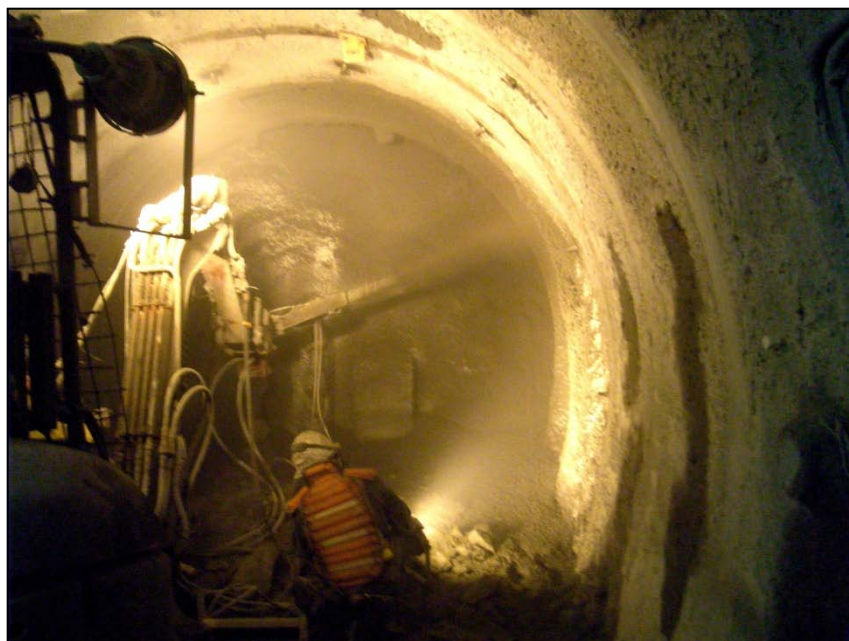
低アルカリ性コンクリート材料の吹付け状況 (140m調査坑道の例)
