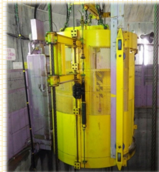
人キブル(工事用エレベーター) 定員11名で運用(案内者、操作者含む)
