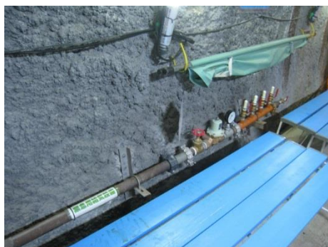
緊急用給気設備
