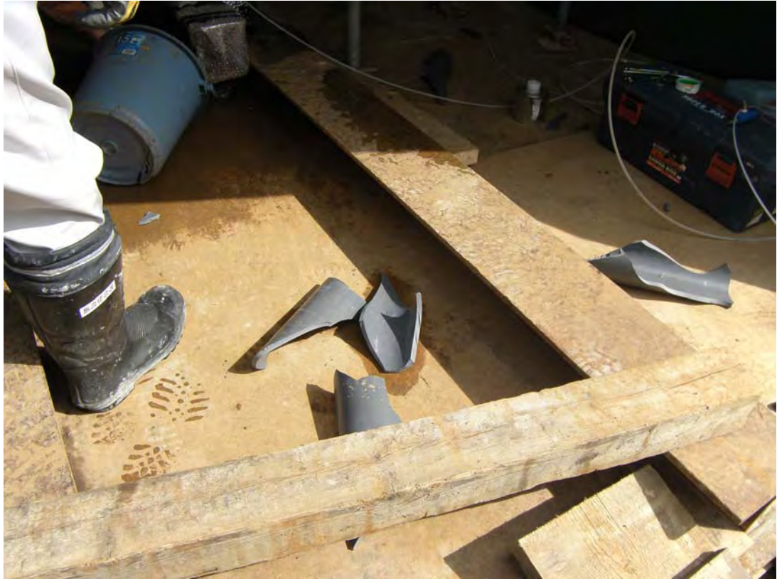
写真2 破損した塩ビ管
