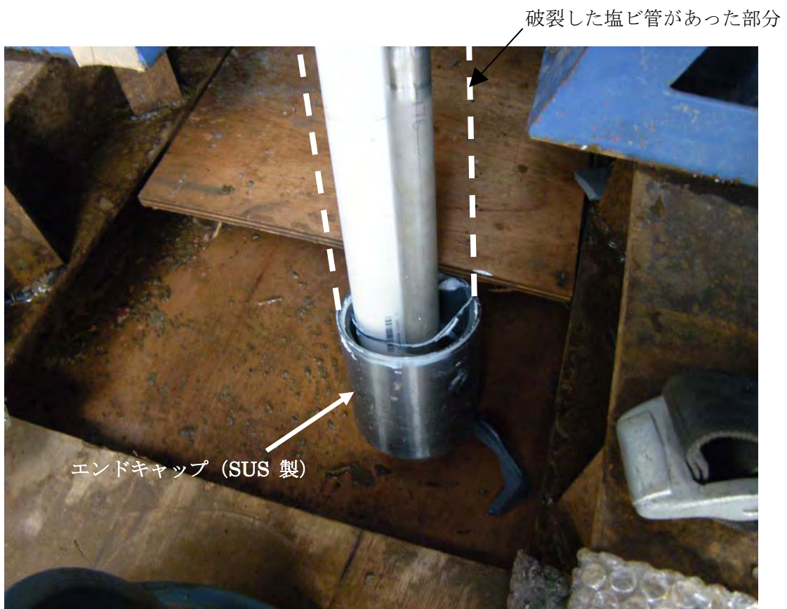
写真3. 破裂した部分
