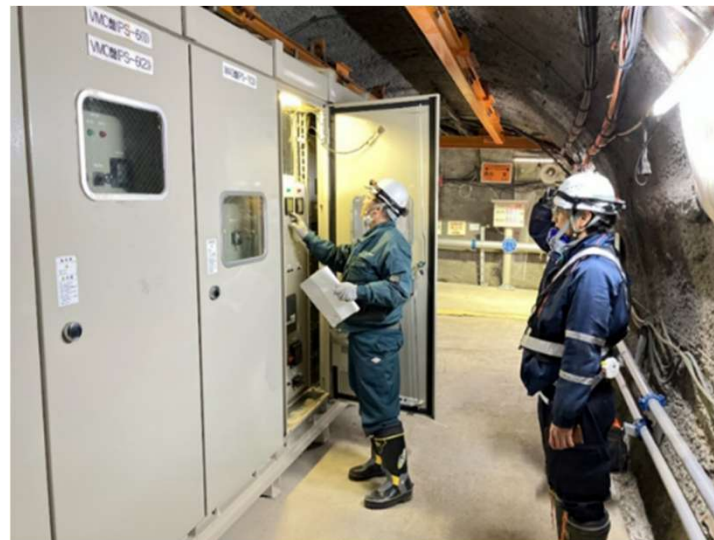
電気設備の保守点検
