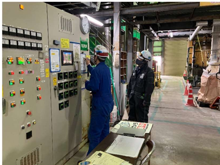
排水処理設備の運転・監視
