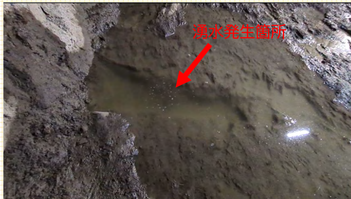
断層からの湧水の状況 (試験坑道8)
