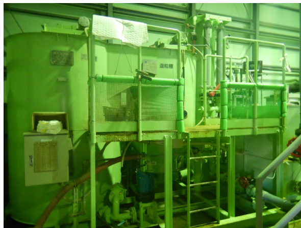
(b) 濁水処理設備
