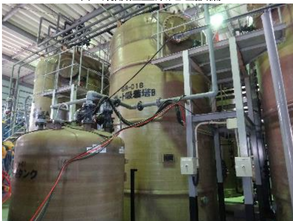
(c) 脱木ウ素設備 (1号機)
