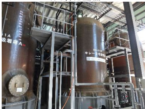
(d) 脱木ウ素設備 (2号機)
