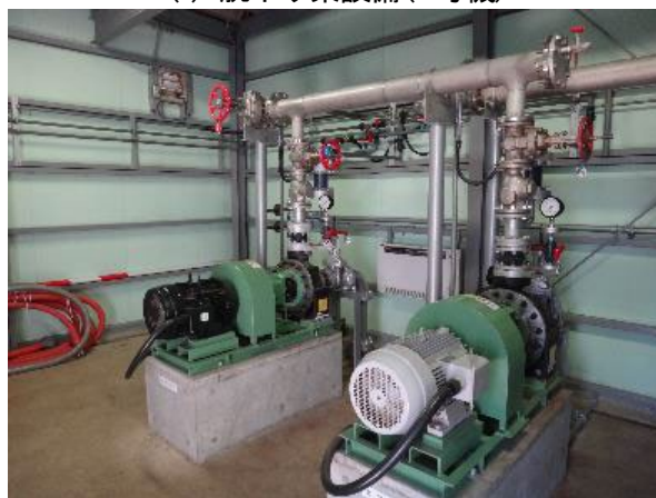
(f) 揚水設備
