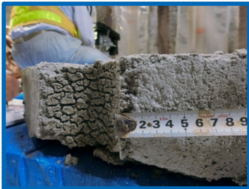
緩衝材ブロックのひび割れ
