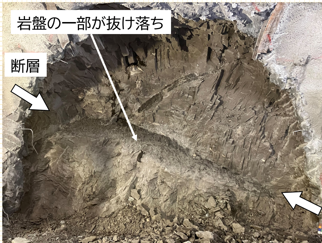
坑道と交差する断層の例(500m)
