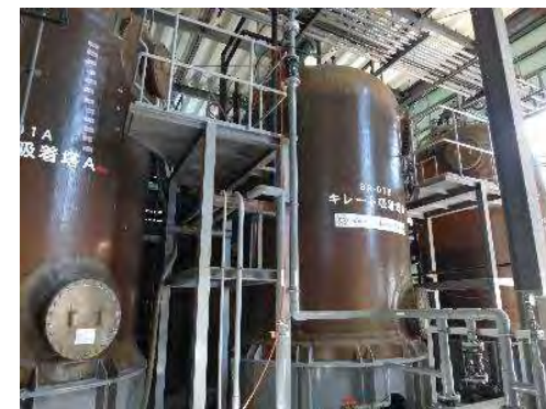
脱ホウ素処理設備
