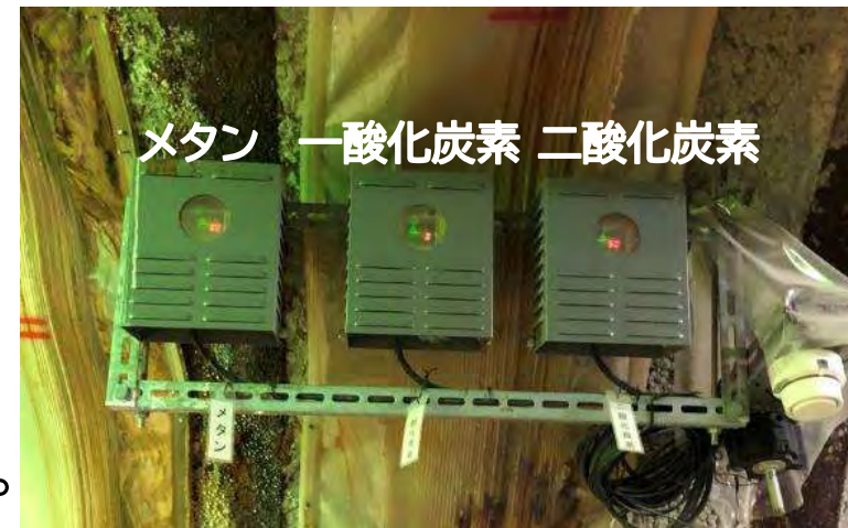
地下の環境を監視するセンサー
