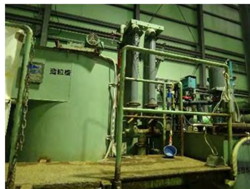
濁水処理設備
