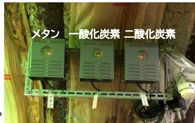
地下の環境を監視するセンサー
