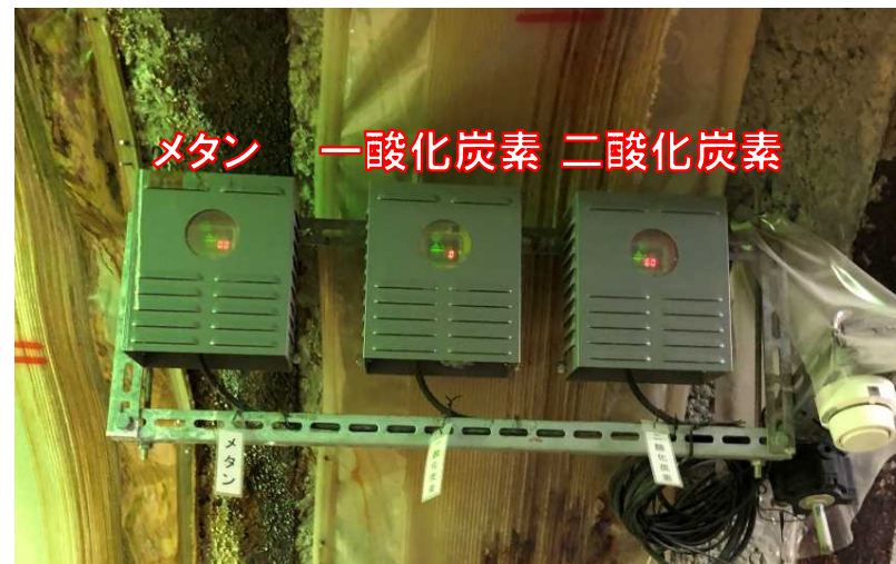
地下の環境を監視するセンサー
