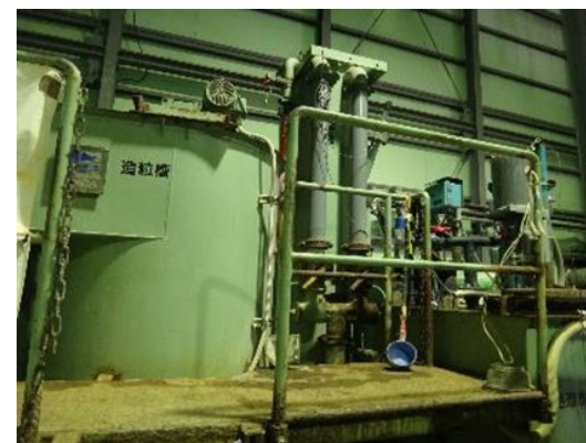
濁水処理設備
