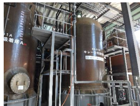
脱ホウ素処理設備
