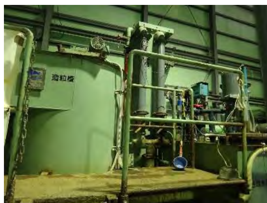
(b) 濁水処理設備
