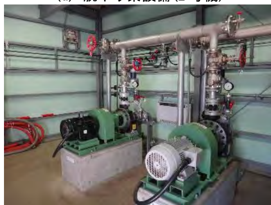
(f) 揚水設備
