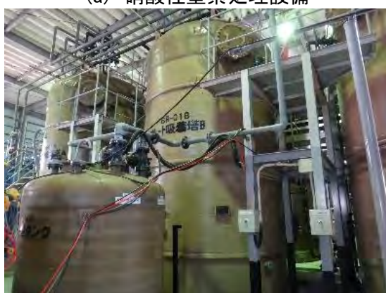
(c) 脱ホウ素設備(1号機)
