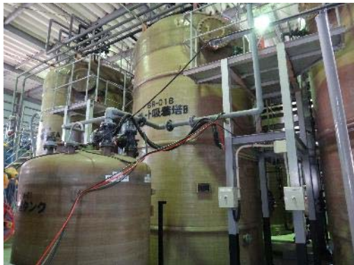
脱ホウ素設備(1号機)
