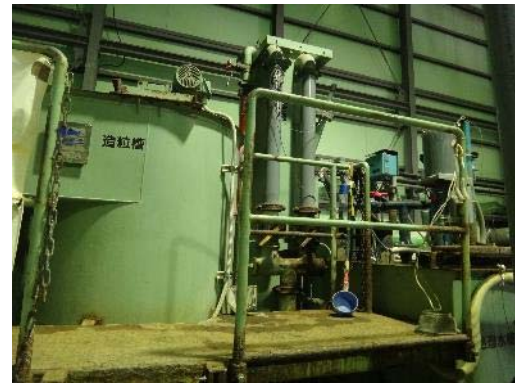
濁水処理設備
