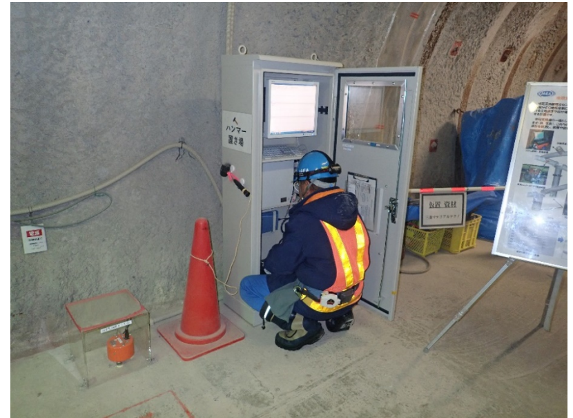
地震観測モニターの動作状況確認
