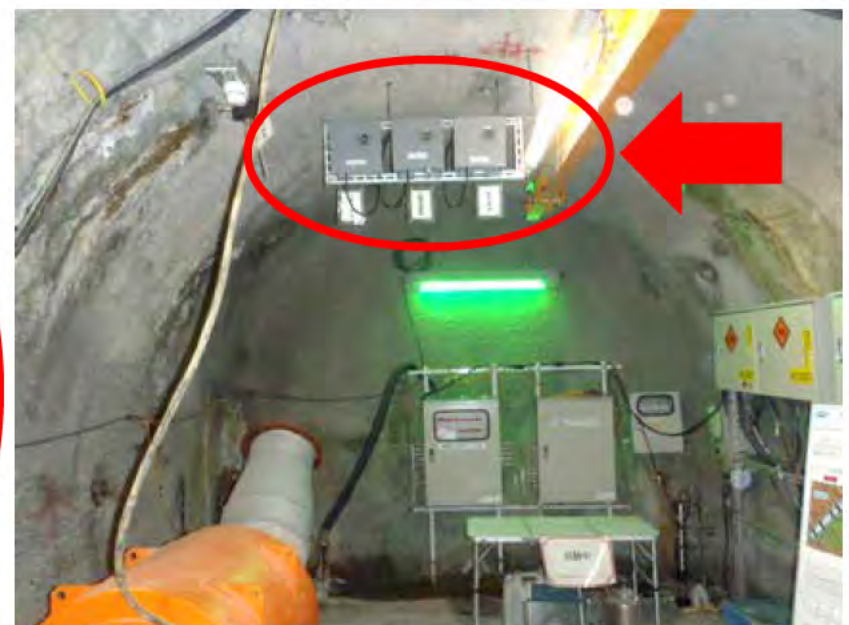
地下坑道内のセンサー
