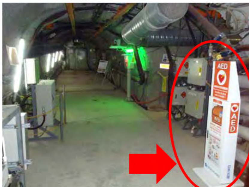
地下坑道内のAED
