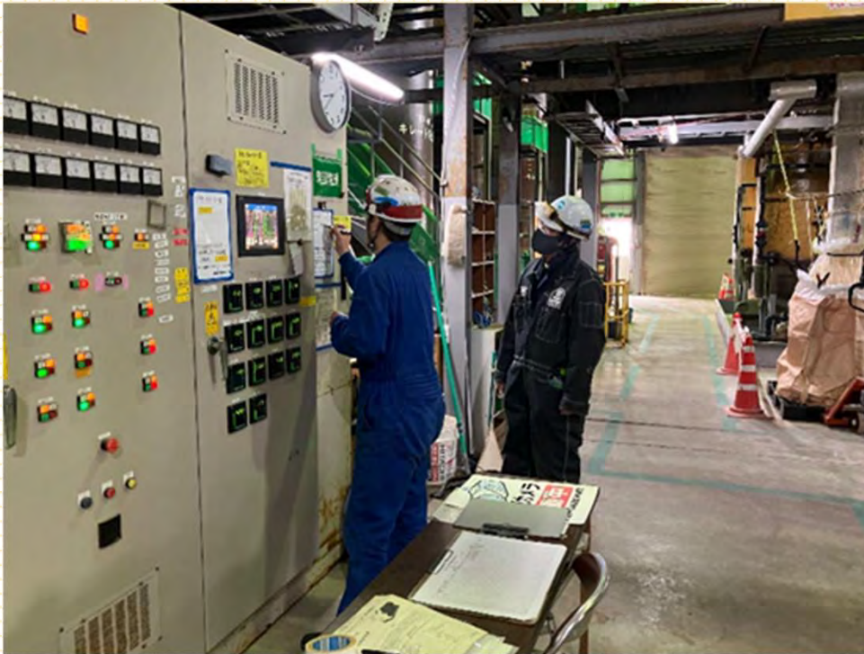
排水処理設備の運転・監視
