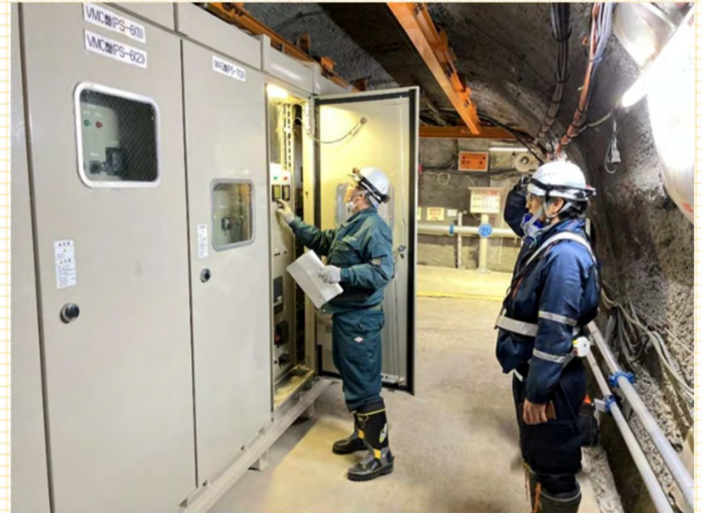
電気設備の保守点検
