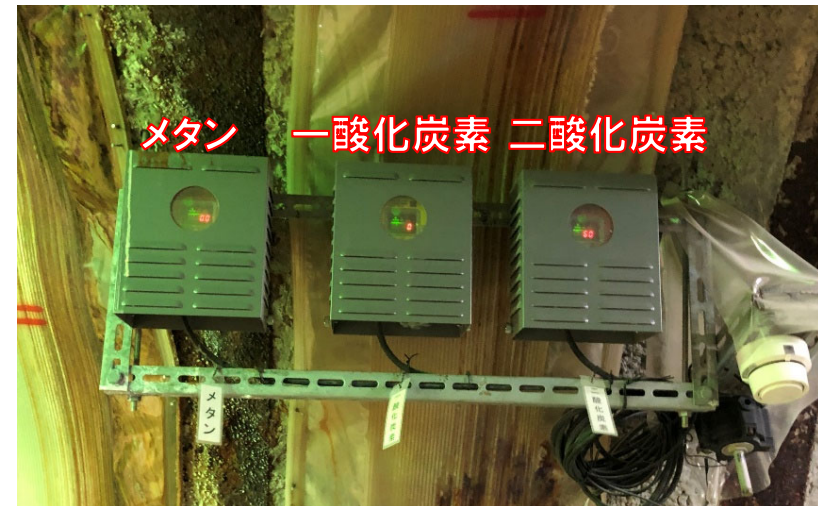
地下の環境を監視するセンサー
