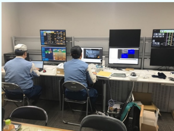
中央管理室の写真
