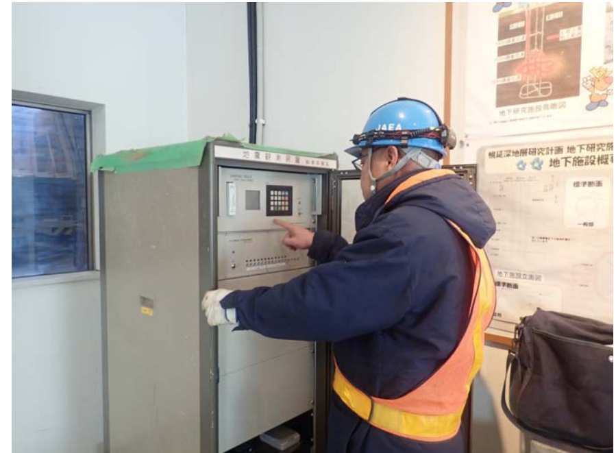
地震観測装置メンテナンスの様子 (西立坑アクセスルーム)
