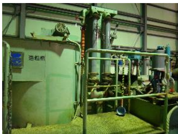
濁水処理設備
