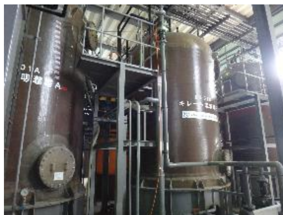
脱ホウ素設備
